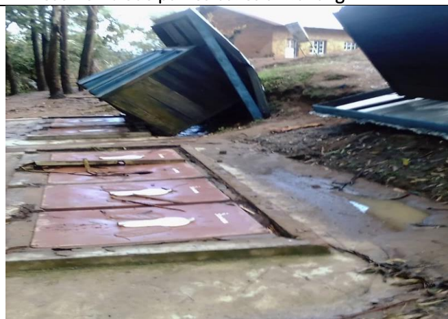
Latrines emportées par le vent de l'EP Mwangaza dans l'AS Mukongo
