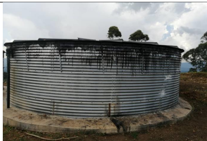
2eme réservoir endommagé par le feu
