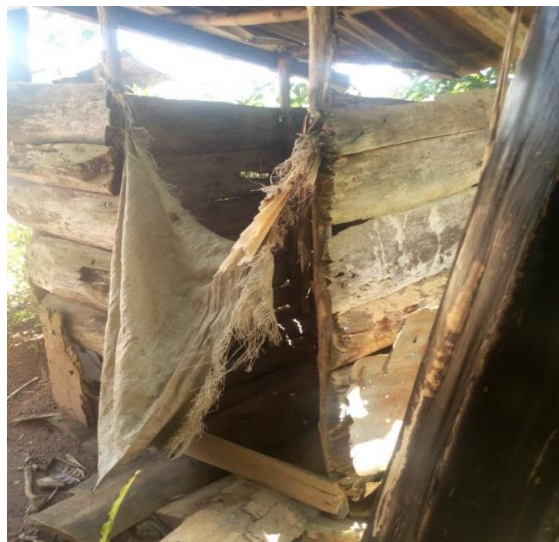
Une des latrines utilisées par les personnes déplacées internes dans un ménage de l'Aire de Santé de BUHUMBANI.
