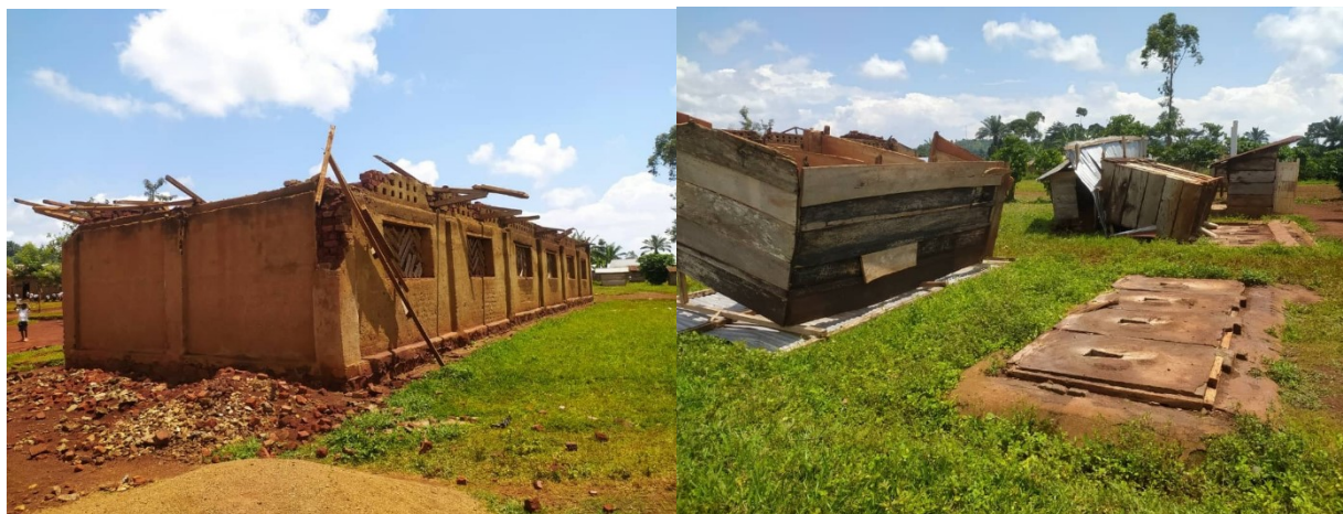
Les dégâts d'une pluie diluvienne du 17 juillet 2022 a l' EP Mangina :toitures de 3 salles de classe et 12 lunette de latrines emportées
